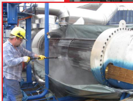
Echangeur à faisceau de tubes
