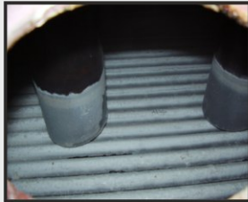
Kessel, rauchgas- und wasser-/ dampfseitig
